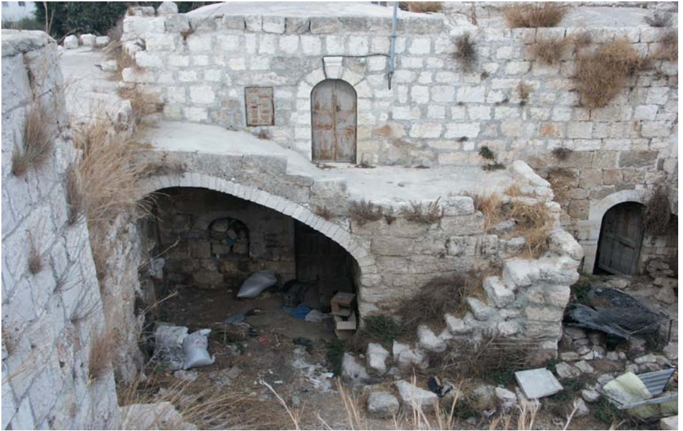
شكل (١٧): حوش دار ناصر- بيت رقم ٦ و ٧، نماذج من المداخل بعقود رومية. (تصوير الباحث في عام ٢٠٠٤م).
